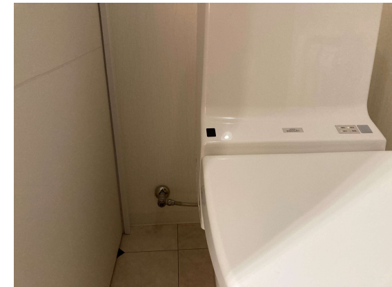
トイレ止水栓
